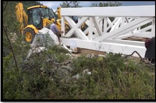
Fotoğraf 5. Çatak Kanyonu Cam Seyir Terası'nın çelik konstrüksiyonu 2017 ağustos ayında yerleştirilmiştir (URL 5).
