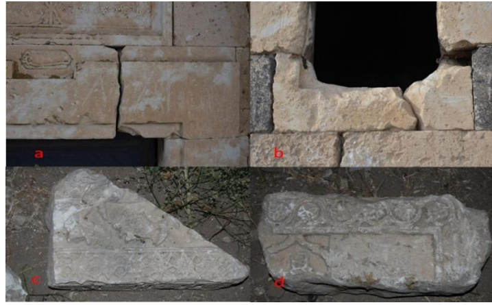
Fotoğraf 8. a-b. Duvar örgü malzemesinde kırılma, c-d. Mezar taşlarında kırılma
