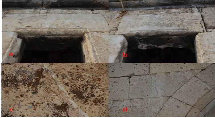
Fotoğraf 7. a-b. Kabuklanma, c-d. Çatlak oluşumu
