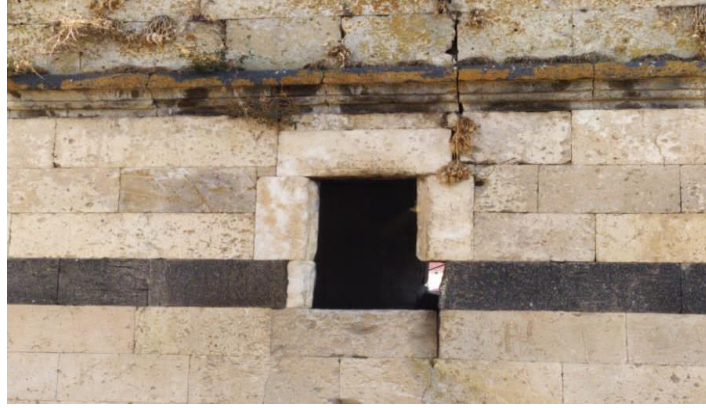
Fotoğraf 5. Batı cephesi birim malzeme kaybı
