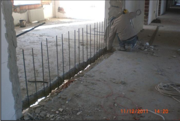
Şekil 4. Betonarme döşemelerde açılan boşluklar
