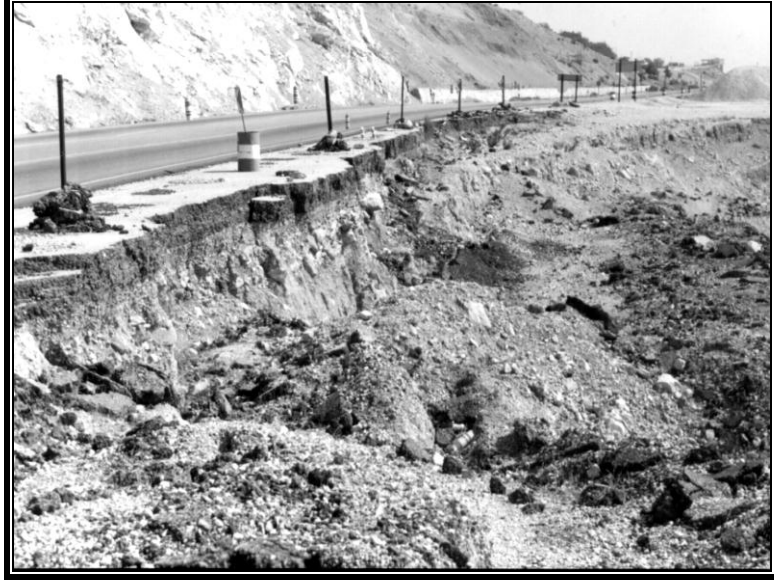
Fotoğraf 2. Belen Geçidi'nde Kütle Hareketleri Nedeniyle Yolun Kaydığı Kesim.
