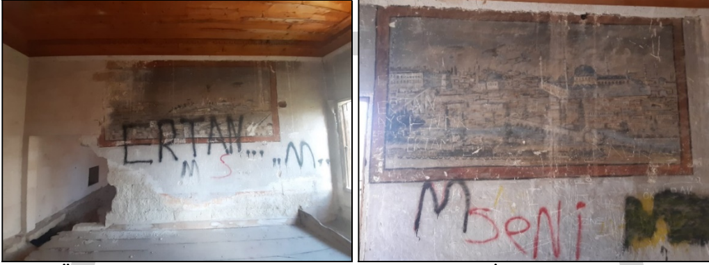
Resim 8. Ürgüp Sucuoğlu Konağında Görülen Yapısal ve İnsan Kaynaklı Bozulmalar, (Kişisel Arşiv, 2021)
