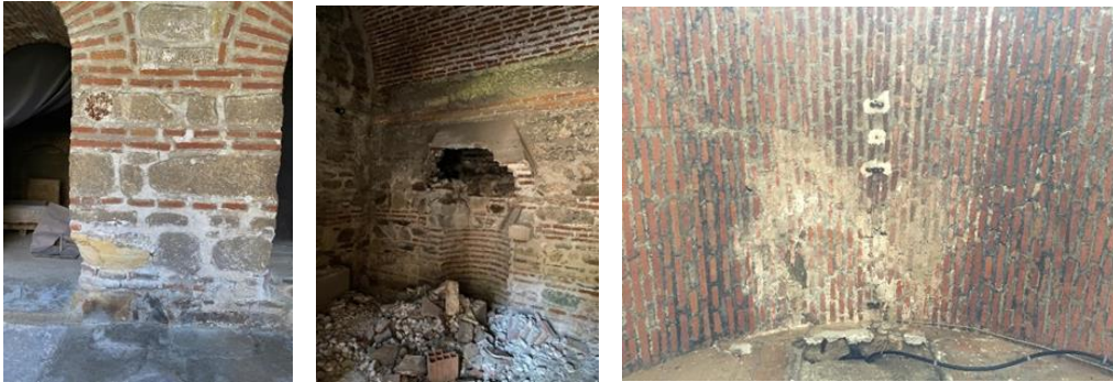
Fotoğraf 21: a) Zemin Kat Duvar ve Ayaklardaki Bozulmalar, b) 1. Katta Yıkılmış Ocak b) Tavandaki Bozulmalar
