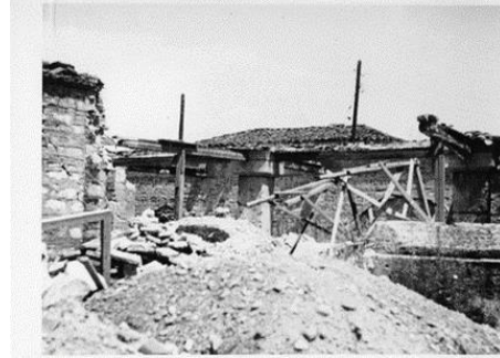
d) Ahır Bölümünde Çöken Çatı
