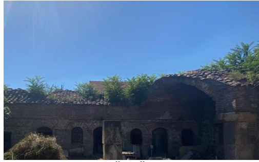
Fotoğraf 22: ZK-35 Üst Örtüsü Yıkılmış Revak
