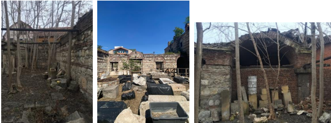
Fotoğraf 12: a) Yıkılmış Üst Örtü b) Doğu Kolu Görünümü b) ZK41 No'lu Mekândaki Muhdes Duvar
