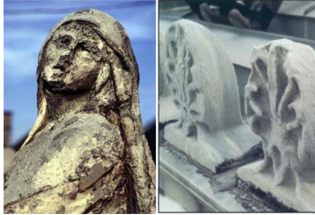
Şekil 1. (a) Asit yağmurları tarafından bozunuma uğrayan bir heykel, (b) Philadelphia Tüccarlar Borsası'nın çatısı (1832'de inşa edilmiştir).
