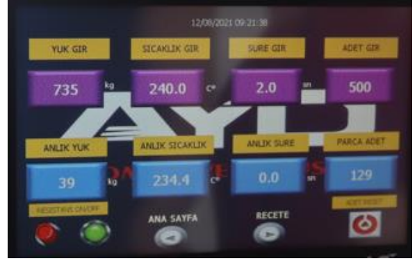
Şekil 2. SCADA Panel Görüntüsü
