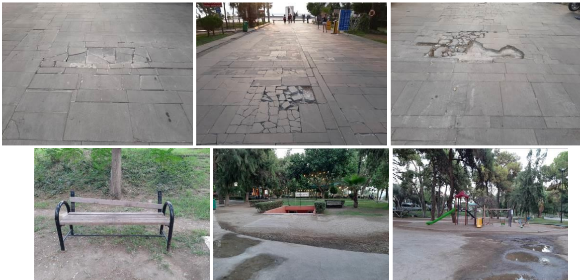
Şekil 6. Karaalioğlu Parkı'ndaki Bakım/Onarım İhtiyacı Olan Alanlar
