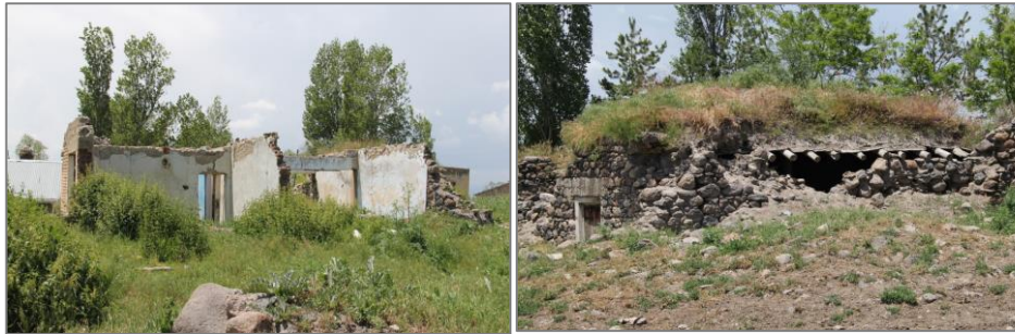
Fotoğraf 2. Ortabahçe Köyü'nde 2004 depreminde zarar gören konutlardan görüntümler.
