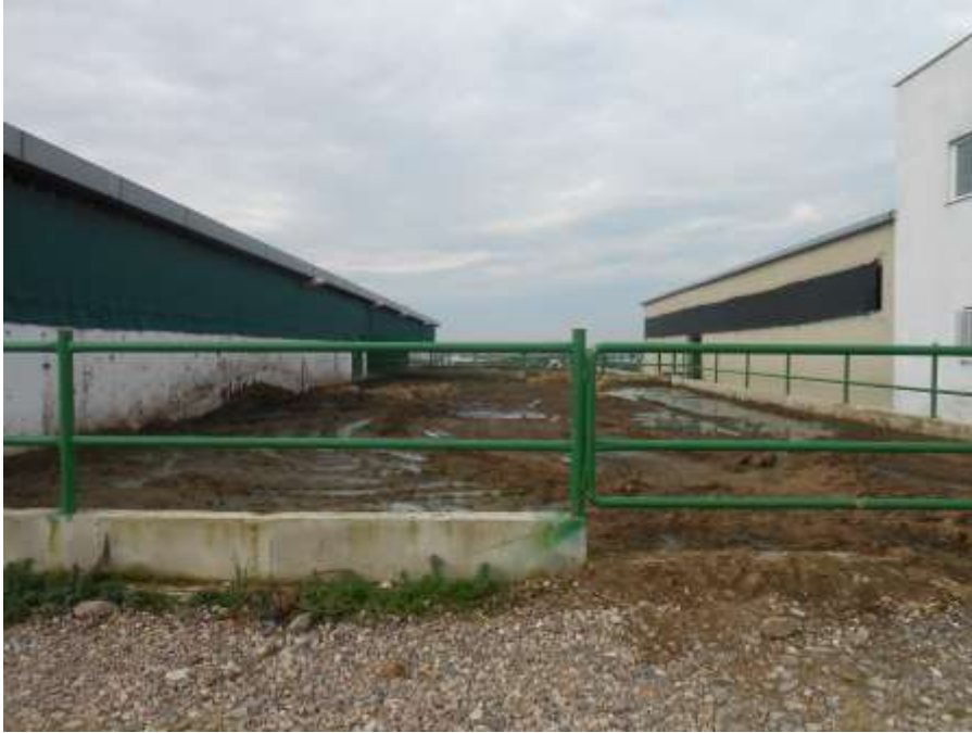
Fotoğraf 5. Yer altı suyu seviyesi yüksek olan alanlardaki çamurlaşma
