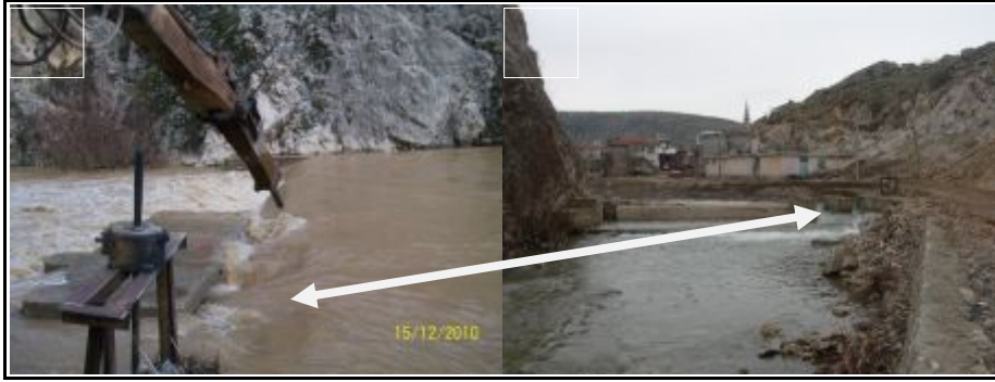
Fotoğraf 1: Bozkır Çıkışında Sulama Amaçlı Regülâtör. A- Taşkın Esnasında Regülâtörün Yıkım Anı, B-Yıkımdan Sonraki Durumu
