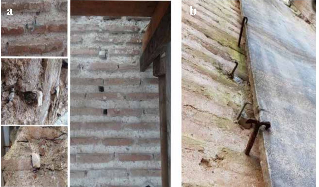
Resim 9: (a) Duvarda Tespit Edilen Taş Takozlar; (b) Farklı Özellikteki Metal Donatılar ve Dış Cephe Kaplama Taşı
