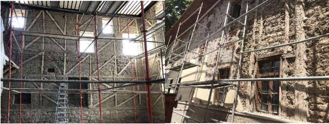
Şekil 4. Taşıyıcı sisteme ve yapıya yapılan yanlış müdahaleler
