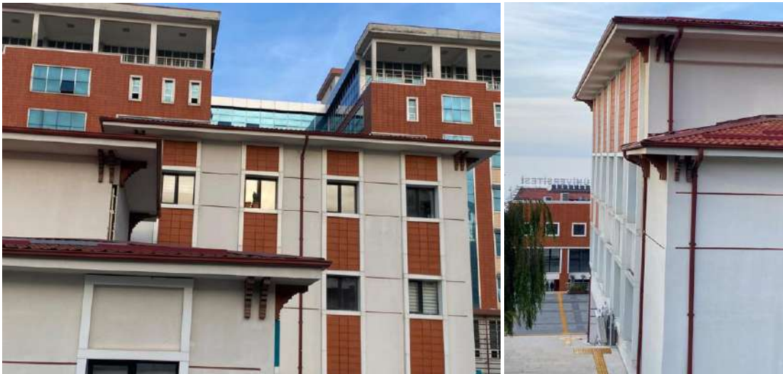
Şekil 26. Recep Tayyip Erdoğan Üniversitesi İlahiyat Fakültesi binası ve kütüphane binasından saçak detayları (Akar, 2021)
